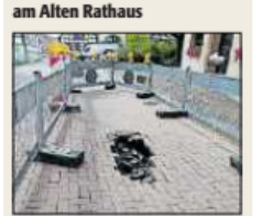
Die Straße ist am Marktplatz eingegraben und muss repariert werden.
